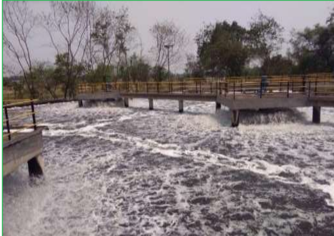
Bilaspur (Domuhani) 54 MLD
